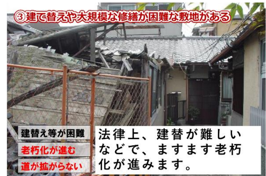
管理不全状態の空き家(中京区)
